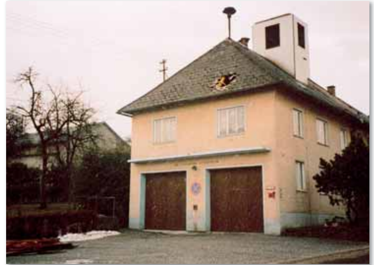
Sturmschaden am alten Feuerwehrhaus, 26./27. Jänner 1995
